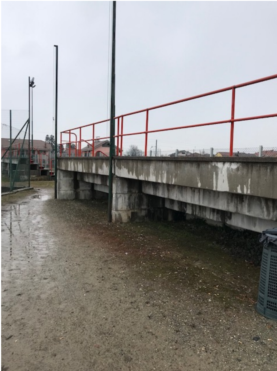
Imm.2 Prospetto nord di tribunetta del Campo Sportivo Comunale in via De Gergorio di Sant'Elia.e nord-est dell'edificio oggetto di intervento da strada pubblica (via Roma)
