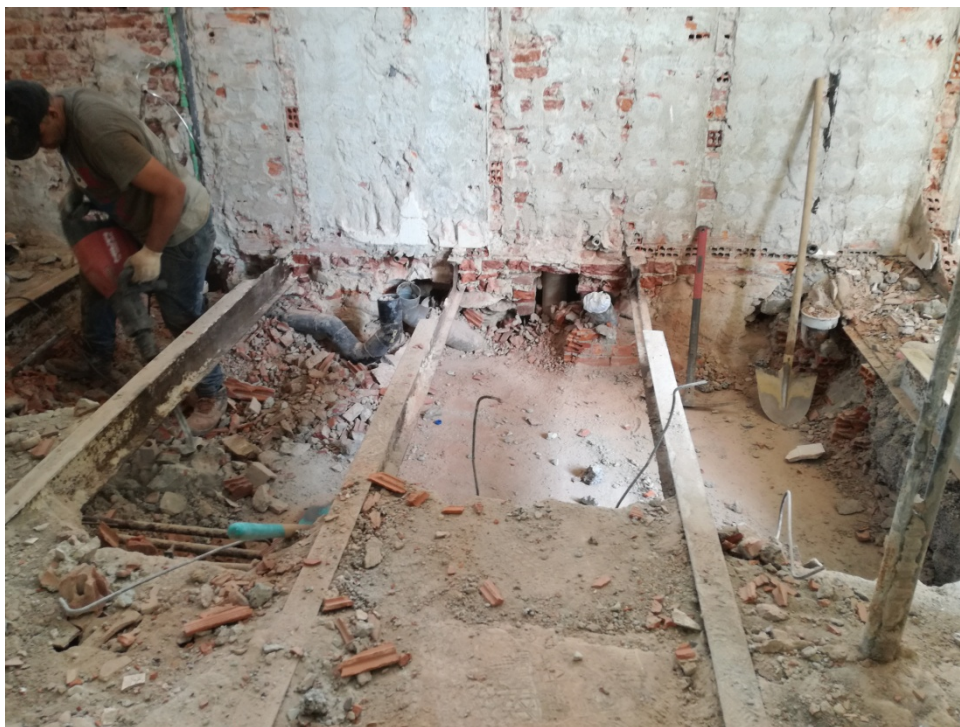
Immagine n. 3 - rimozione delle macerie al di sotto della pavimentazione dei bagni al piano primo e profili metallici danneggiati in prossimità dell'appoggio
