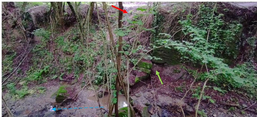
Ripresa fotografica 4 (13/05/24): ripresa frontale del tratto di strada oggetto di intervento. La freccia rossa indica il punto di scarico indicato nella fotografia n. 3 mentre la freccia verde indica il muro parzialmente collassato e con evidenti segni di cedimento. La freccia blu tratteggiata indica la direzione di scorrimento del rio.
