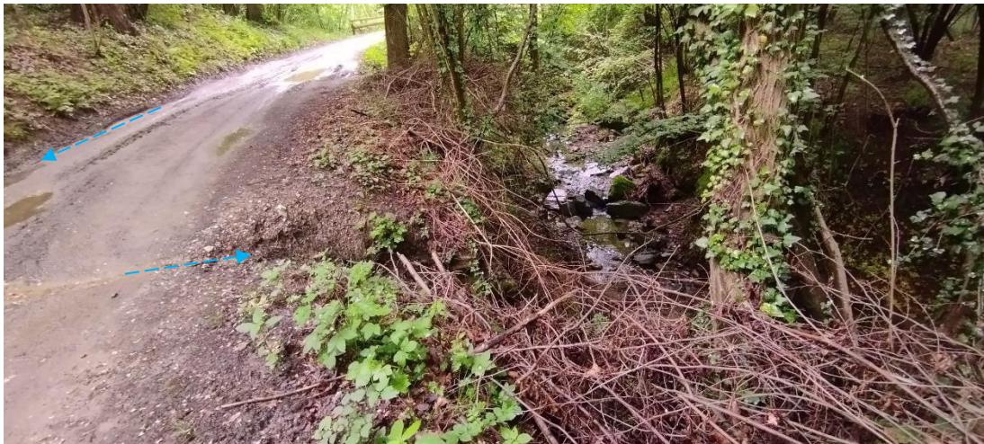
Ripresa fotografica 3 (13/05/24): ripresa da valle verso monte del tratto di strada oggetto di intervento con dettaglio del punto in erosione per lo scarico delle acque non correttamente regimate (le frecce indicano la direzione di scorrimento delle acque).
