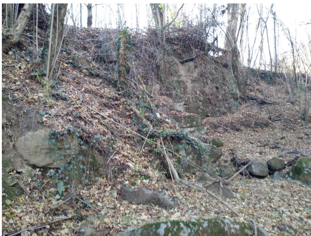
Foto 3 – scarpata da ripristinare
