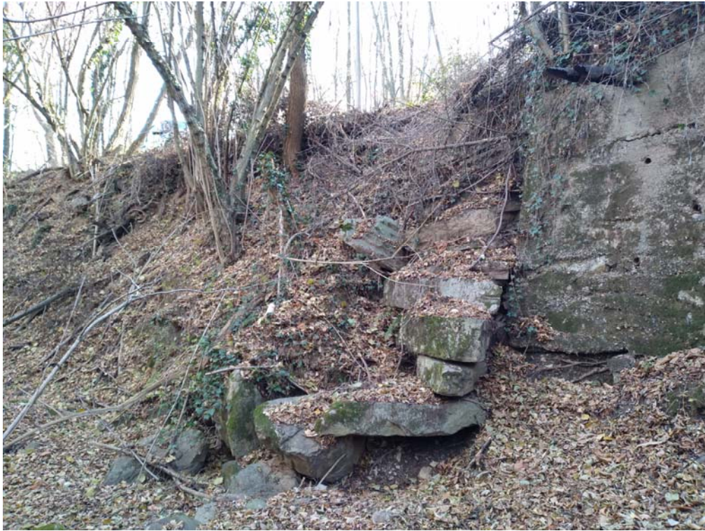
Foto 2 – opera di sostegno crollata e muro in cls in demolizione
